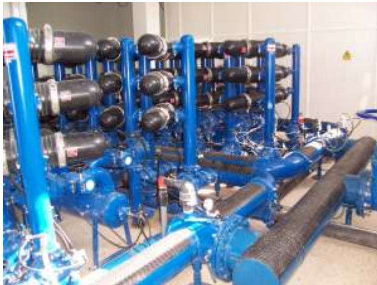
Baterías con filtros de anillas.
