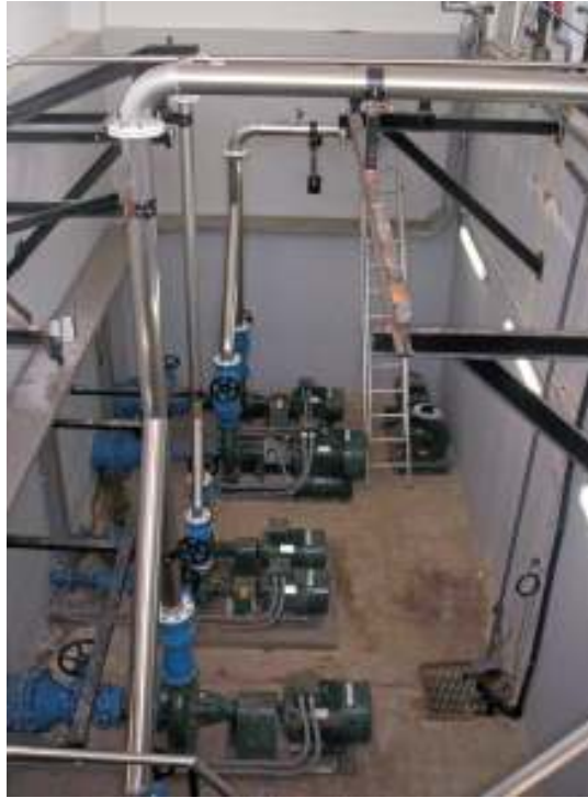
Foso de bombeo
